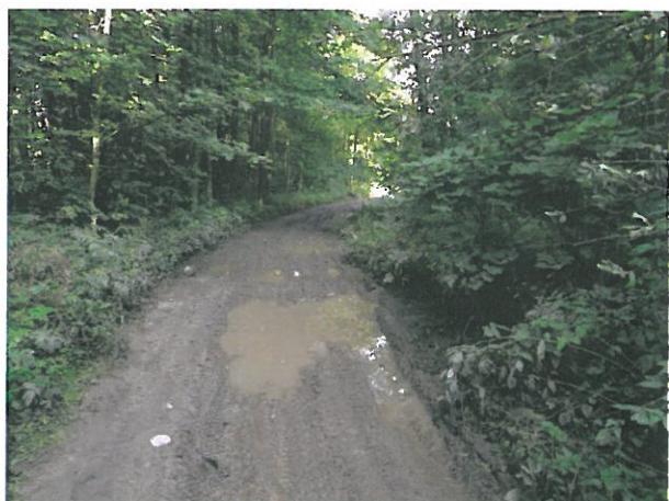
Fot. 6. Zły stan nawierzchni na odcinku północnym
